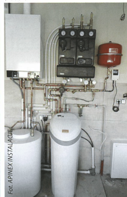
Fot. 3. Odpowiednie grupy pompowe zapewniają możliwie najefektywniejszą dystrybucję energii.
