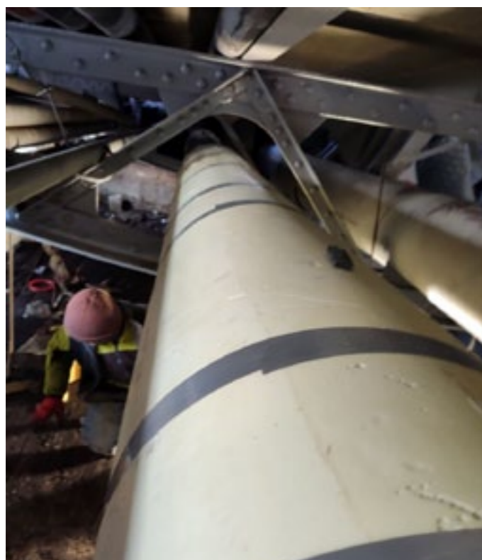
Rurociąg izolowany matami i PUR
