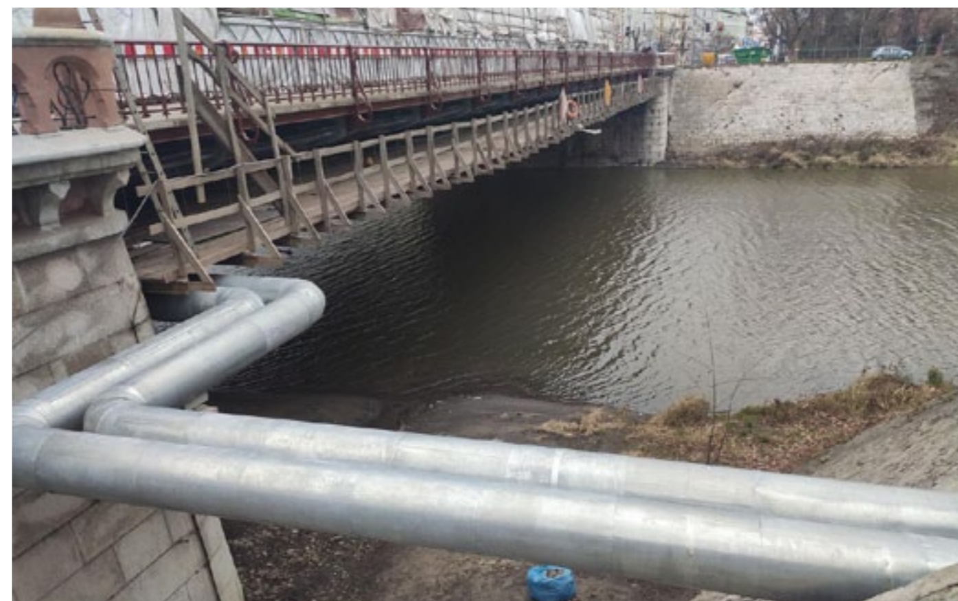
Zaizolowany rurociąg ciepłowniczy (z powłoką tytanową)
