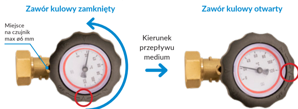
Rys. 1 Zawór odcinający zamontowany na zasilaniu
